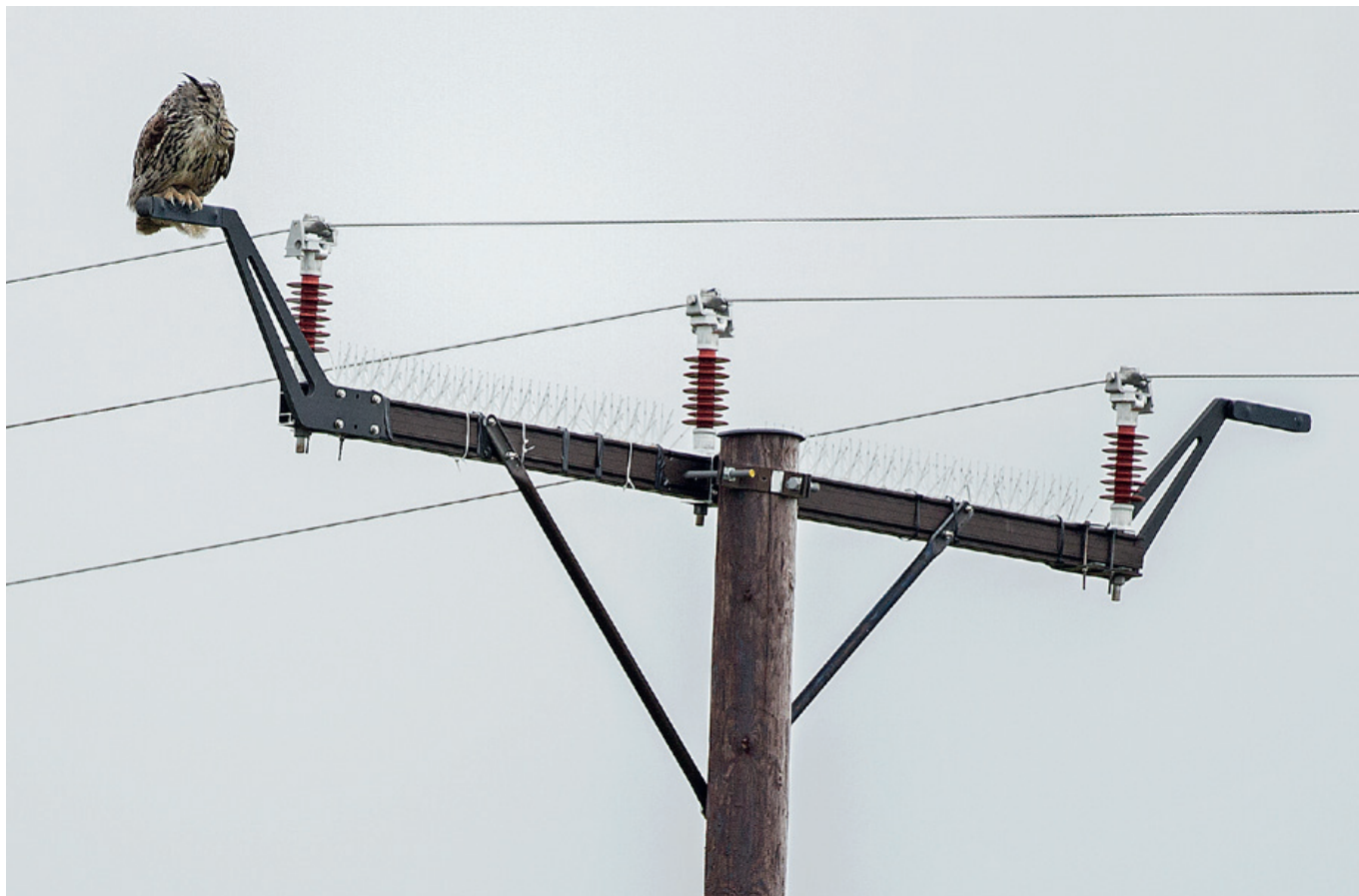
Hubro på «sitteteppe» montert på strømstolpe i Lurøy kommune, Nordland. Stolpekonstruksjonen har også fått påmonterte «fugleavvisere» på toppen, for å hindre at hubroen slår seg ned på den farlige delen av stolpen. Foto: Karl-Otto Jacobsen.
